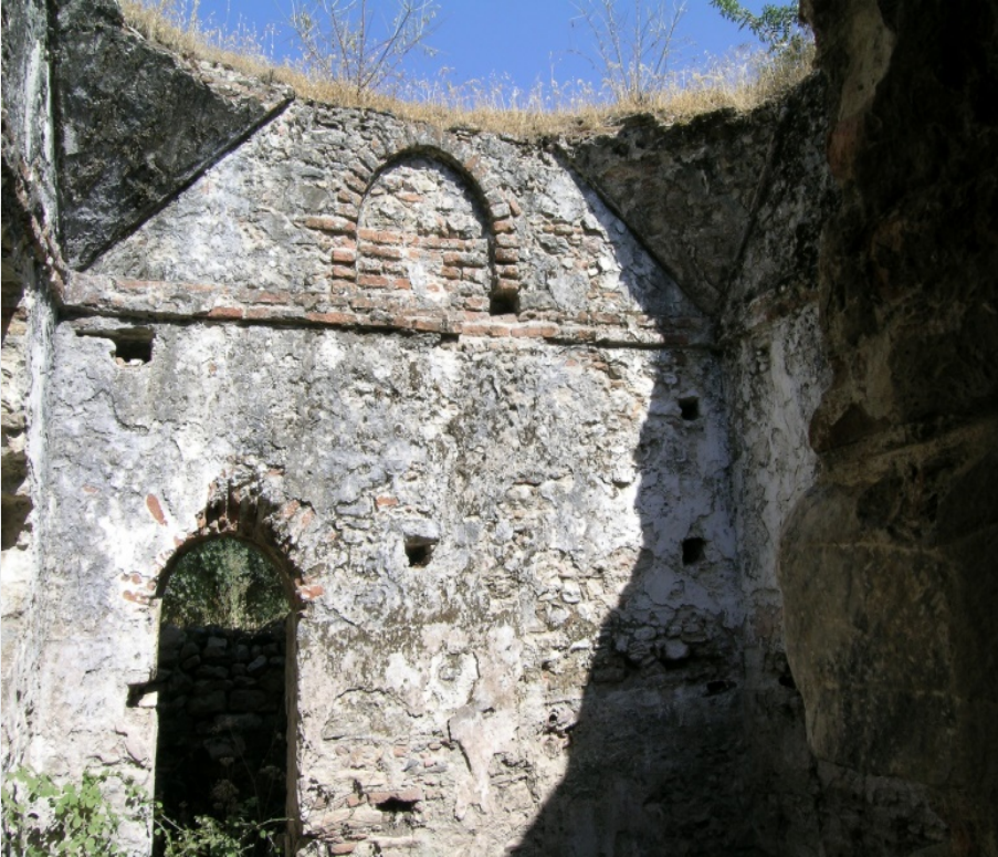
Fotoğraf 8. Selçuk Hamamı İlklik Bölümü Onarım Öncesi Durumu
