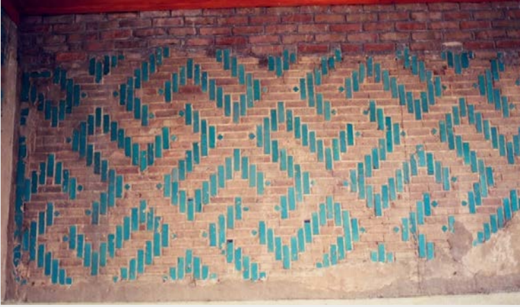
Fotoğraf 14. Duvar yüzeyinde yer alan sırlı tuğla süsleme
